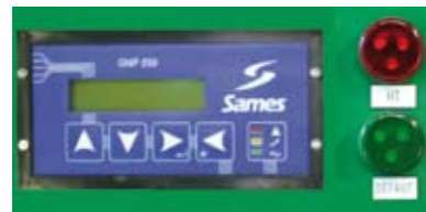
Contrôle panel haute tension (GNP)
